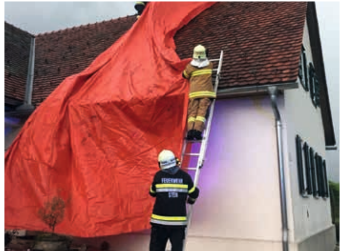
Nach dem Blitzschlag wurde eine Plane zum Schutz angebracht.
