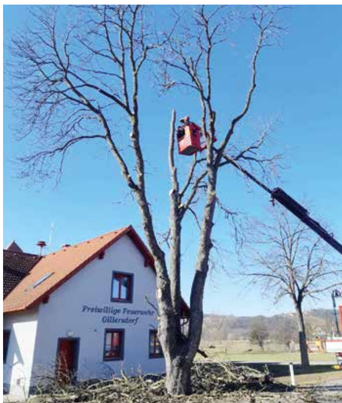
Unter Mithilfe der Stadtfeuerwehr Fürstenfeld wurde der schadhafte Kastanienbaum entfernt.
