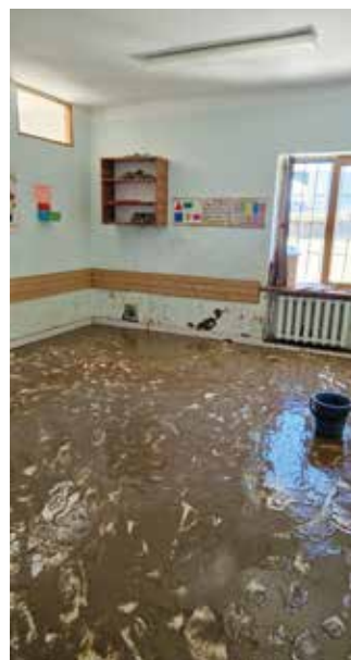
Überschwemmung im Klassenzimmer
